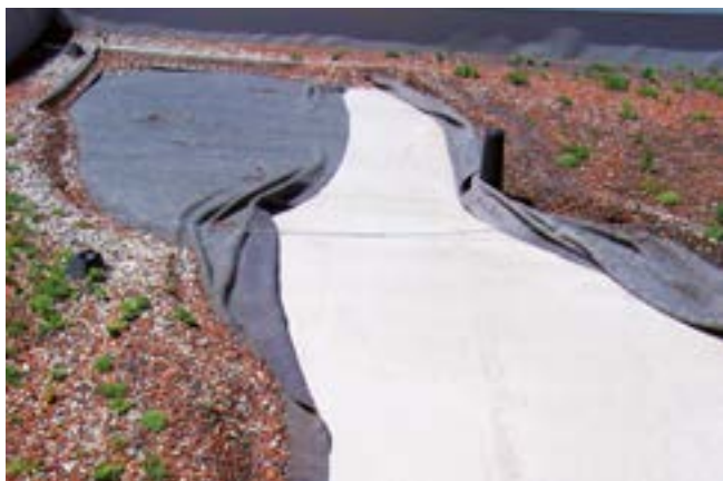
▲ Windschade, wegwaaien net aangebracht substraat en plugplanten.
